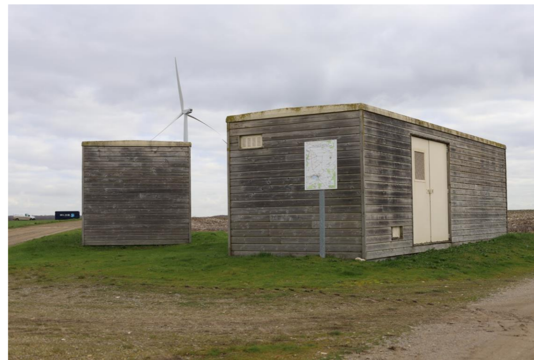
Photo 141 : Exemple de postes de livraison recouverts d'un bardage bois
